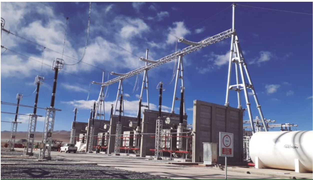
Subestación transformadora del Parque Solar Cauchari
