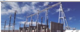
Parques solares en la puna: desafíos técnicos
